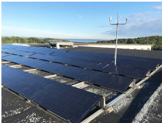
Solceller på Rådhuset
